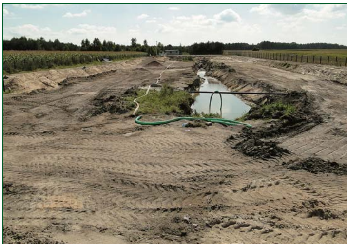
Grunt pod oczyszczalnią w Uniecku okazał się wodonośny, choć w dokumentach napisano, że takim nie jest, i teraz teren budowy trzeba osuszyć
