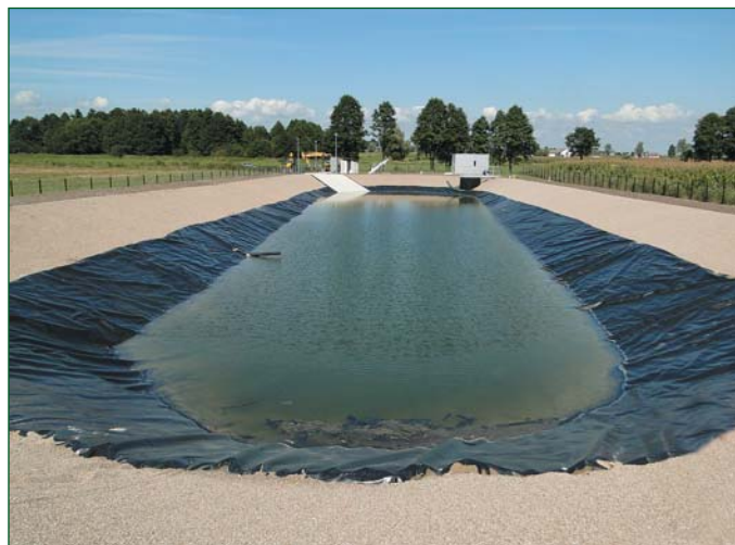
W tej niecce ścieki będą napowietrzane
